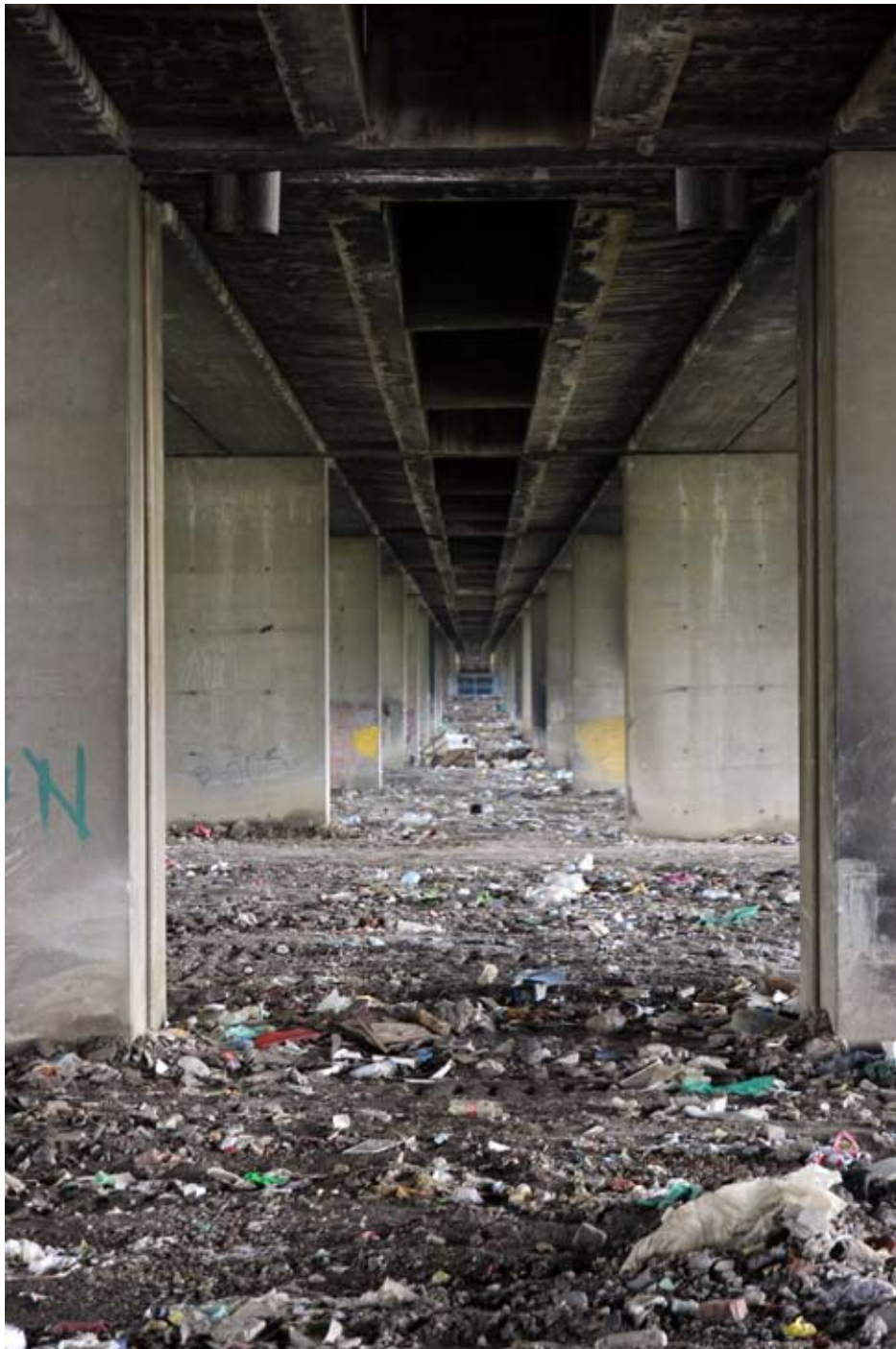
Belvil – neben und unter dieser Brücke lebten mehrere hundert Menschen in selbstgebauten Hütten. Die Stadt Belgrad ließ diese immer wieder räumen.
